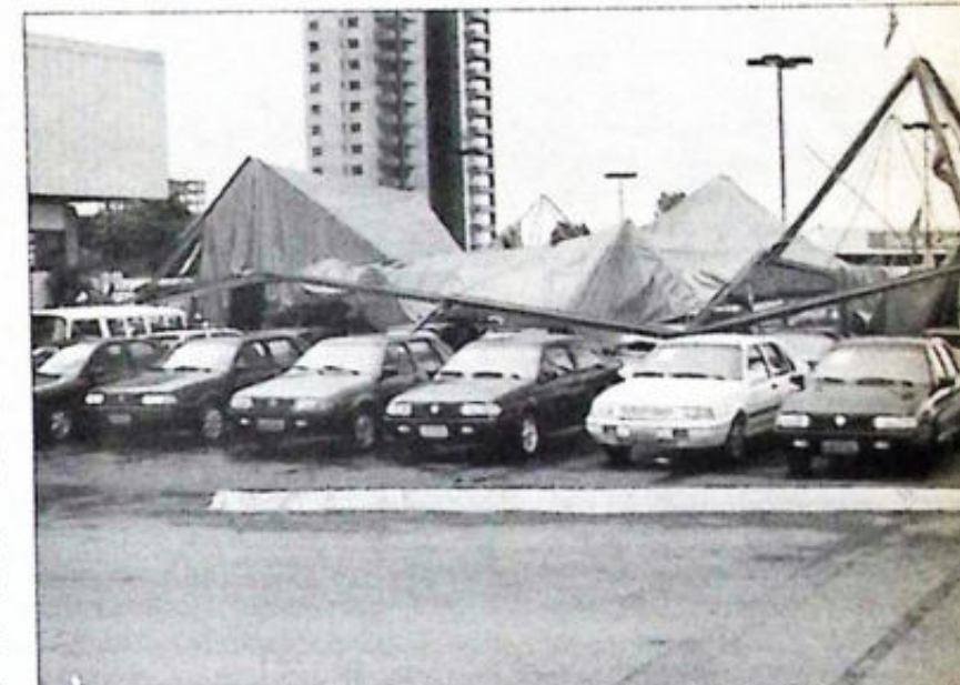
O vendaval destruiu a cobertura de metal da concessionária Belcar
