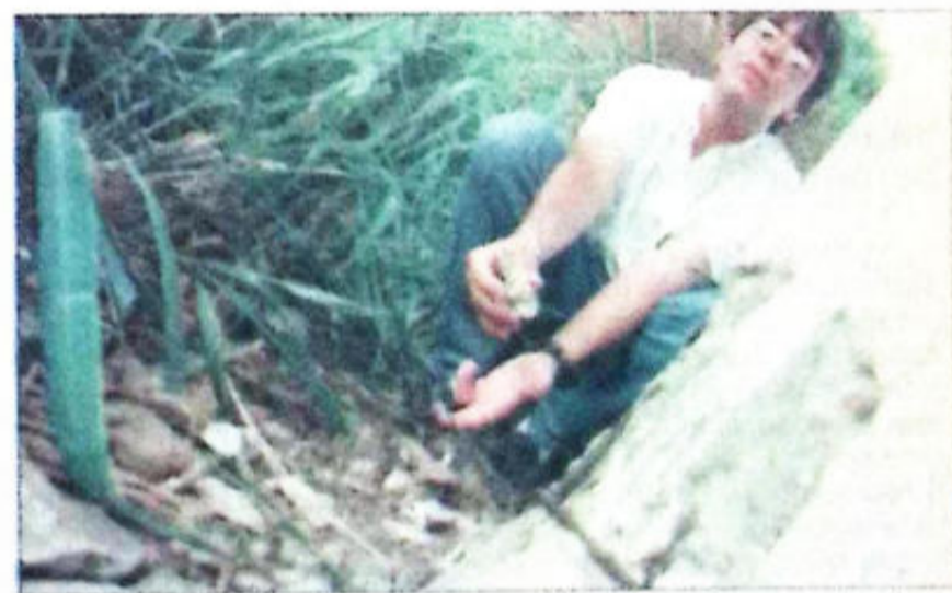
O engenheiro da UCG mostra partes corroídas na base de concreto da obra
