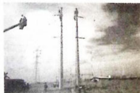
Subestação Goya Implantação da subestação 138/13,8 KV, 33,25 mil KVA de potência
