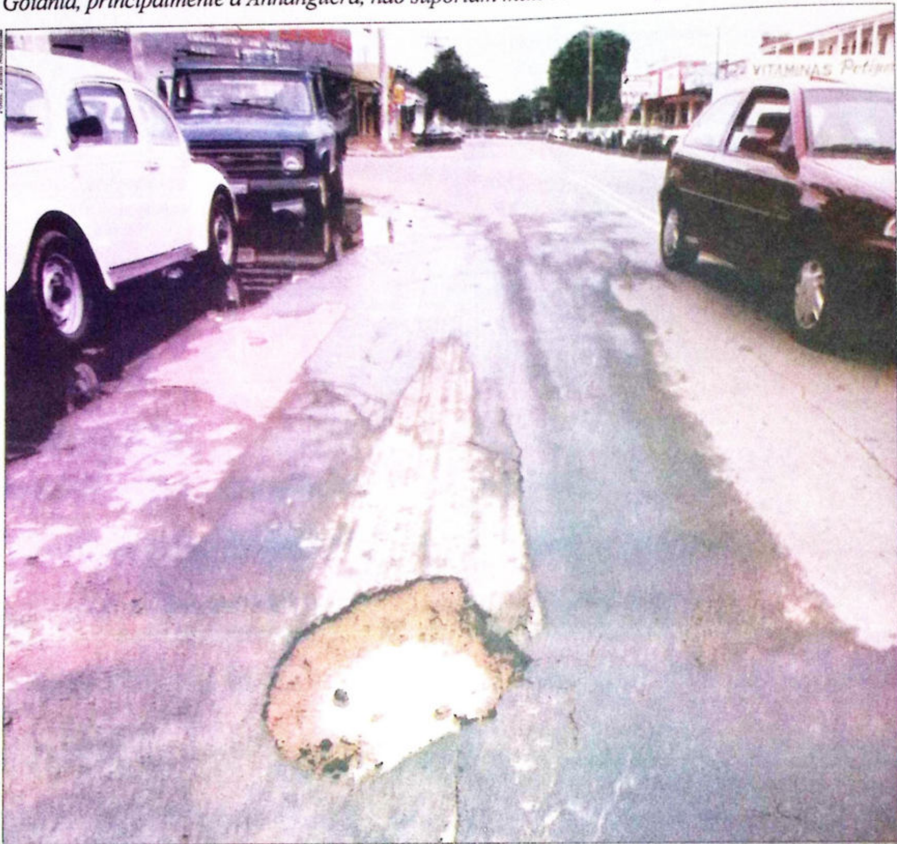
Na época das chuvas, as ruas ficam cheias de buracos, que incomodam e oferecem perigo. Operação tapa-buracos não está mais surtindo efeito
