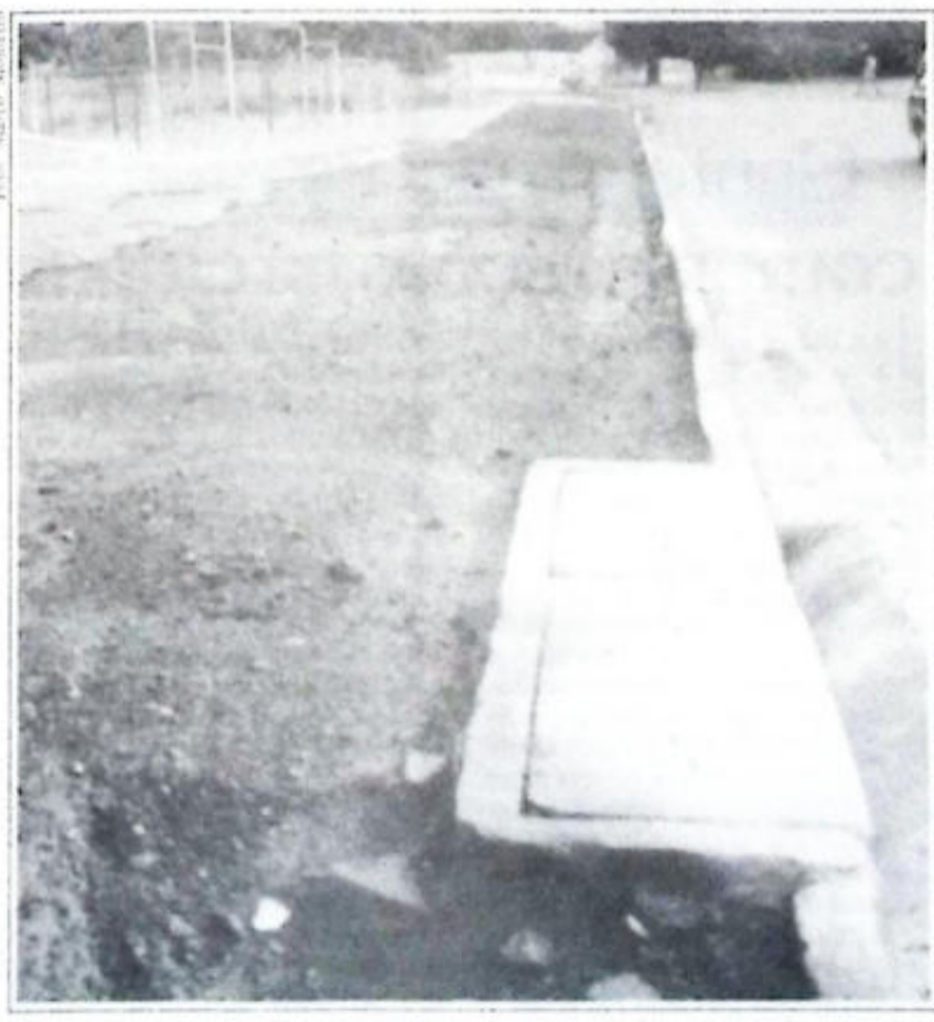
Pista de cooper do Parque Areião: obra inacabada vai por água abaixo
