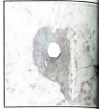
O balaço vazou o muro de tijolo
