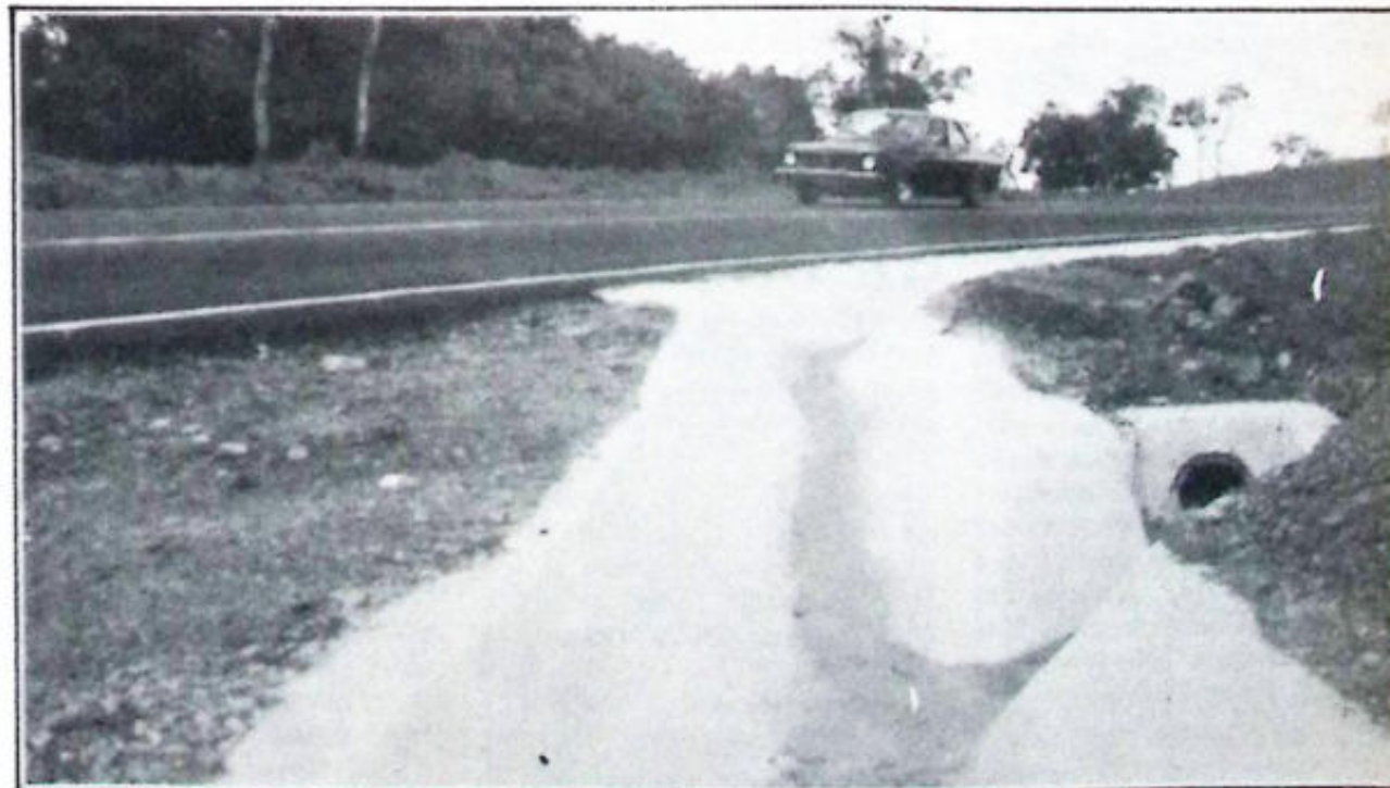
Para prevenir problemas de erosão, a rodovia conta com canaletas de concreto para escoar águas pluviais
